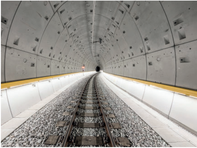
LaneLED GFK, Glatscheras tunnel
